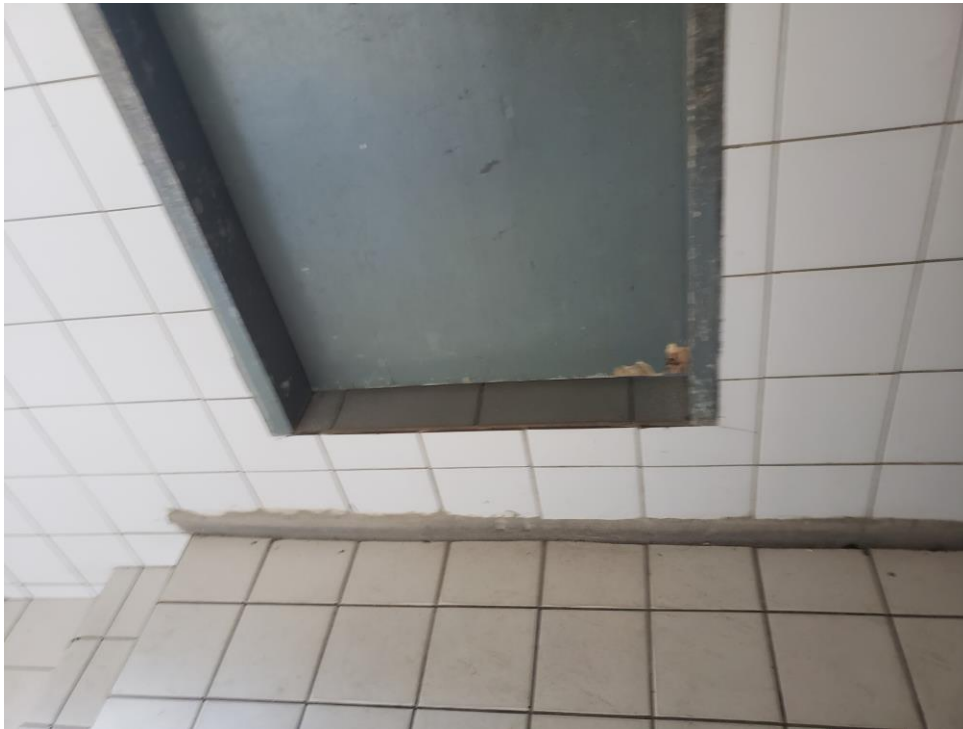
Imagem 04 – Foto tirada in loco do desnível para entrar na sala de aula. Fonte: COINF-SME.
