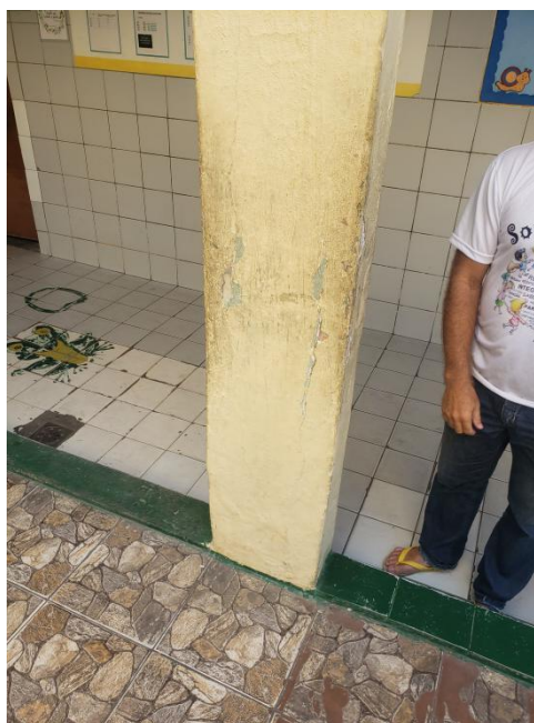
Imagem 06 – Foto tirada in loco do desnível de acesso ao pátio. Fonte: COINF-SME.
